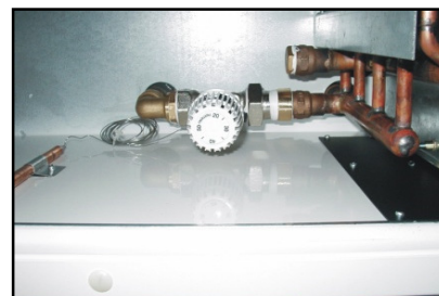
Abbildung des eingebauten thermostatischen Ventils
